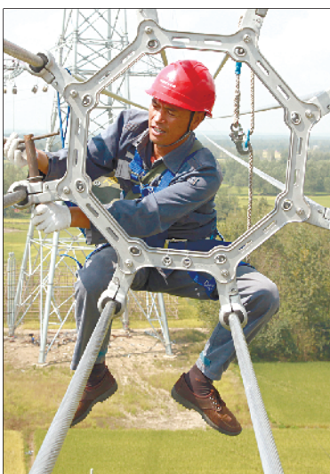
■1000KV 淮上线工程中的广东输电变电人 杨惠平/摄
