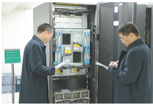
■严格按照制度流程对数据库系统进行巡检
