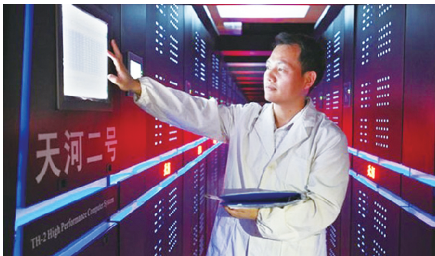
■天河二号 目前位于广州的超级计算中心,主机房面积在4000平方米以上
