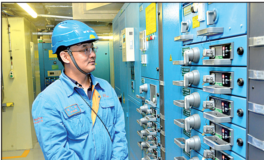
■毕鹏程正在机房查看配电盘工作状况
