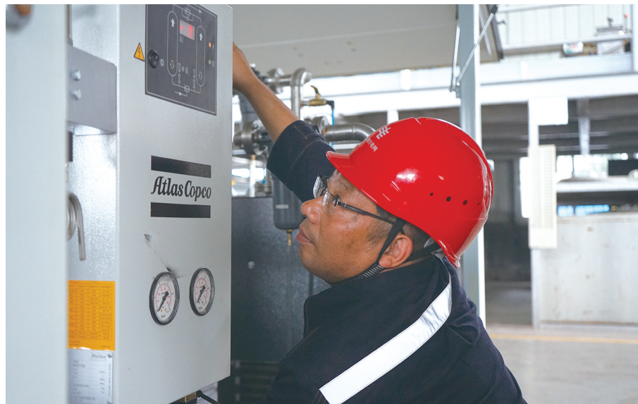
■唐新民在进行真空滤油机调试
