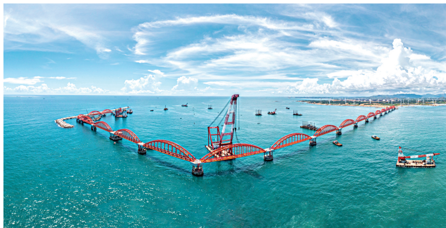
建设中的广东石化30万吨级原油码头疏浚及钢桥安装工程
